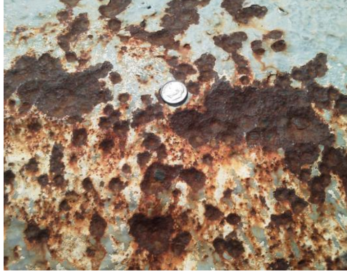
شكل (١): التآكل النقري
